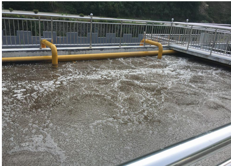
黄山汤口污水厂——AAO一体化池曝气区
