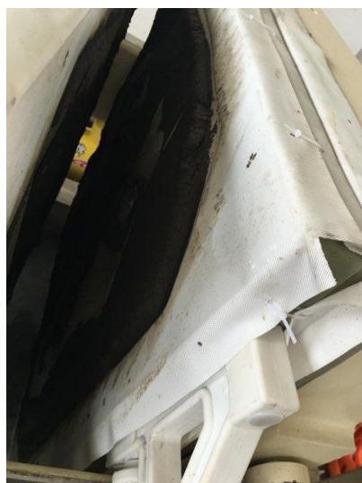
上庸污水厂——综合设备间污泥隔膜压榨机（右图为隔膜中泥饼）
