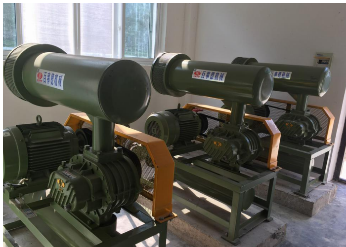
黄山汤口污水厂——综合设备间内的合建式鼓风机房
